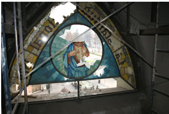
Destrozos en un vitral de la iglesia de los Salesianos, en Cumming con Alameda.
